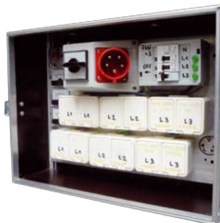
■ Wykonana we własnym zakresie rozdzielnia siłowa z gniazdem przyłączeniowym 32A i kontrolą napięcia na każdej z faz.
