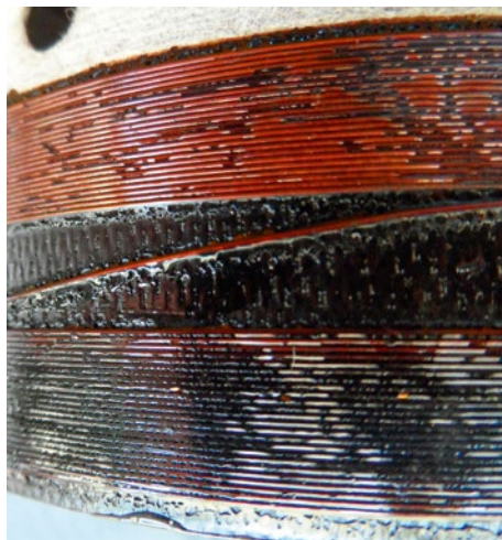
Totalna destrukcja cewek na skutek wysokiej temperatury, nie zawsze musi prowadzić do uszkodzenia neodymowego obwodu magnetycznego.
